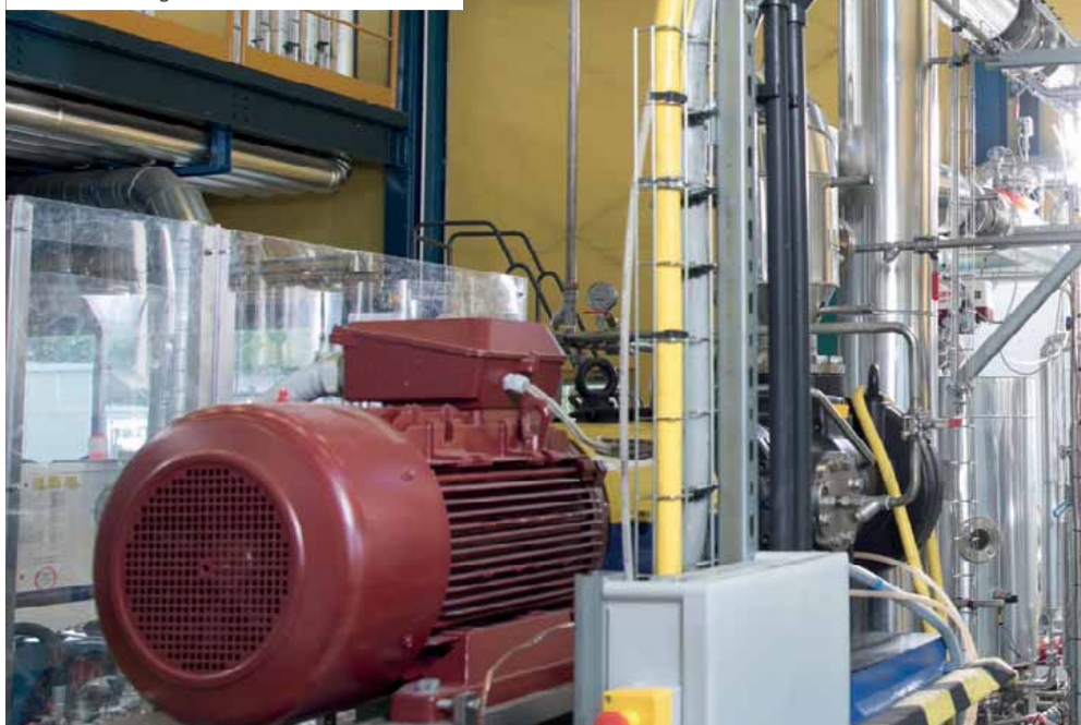
EDF R&D PACO : UNE POMPE À CHALEUR INDUSTRIELLE TRÈS HAUTE TEMPÉRATURE À EAU Moret sur Loing, Seine et Marne
