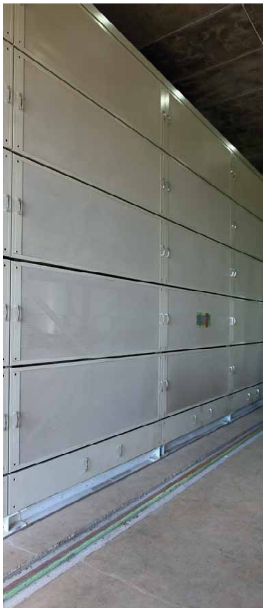
MODULE DE BATTERIES EXPERIMENTALES SODIUM SOUFRE Saint André, La Réunion
